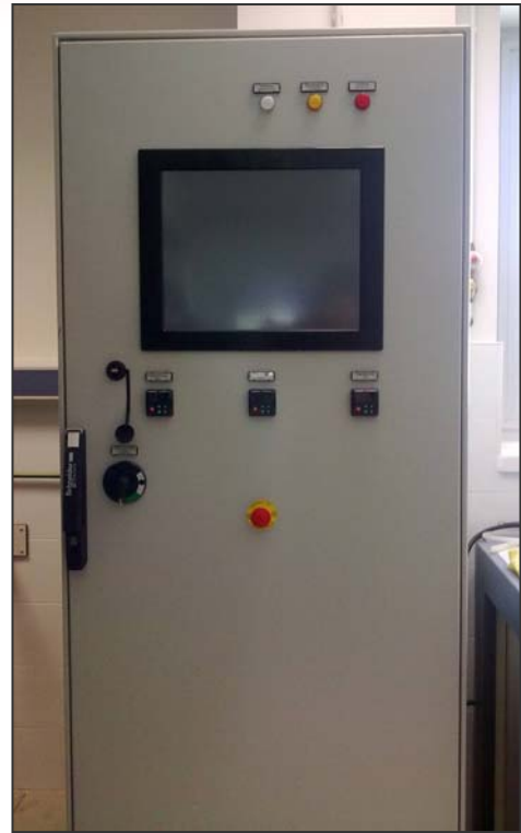
Detalle del cuadro de control.
